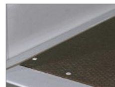
Flakytan skyddad av stålprofil
